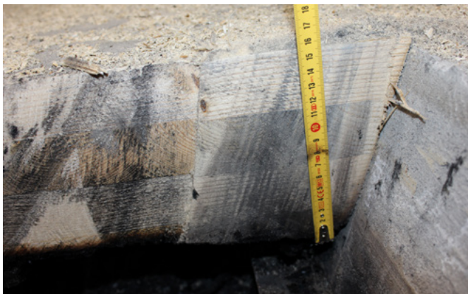
Abbildung 9. Verkohlung im Fugenbereich zwischen DELTABEAM® und CLT-Platte neben dem Fugenbeton.
