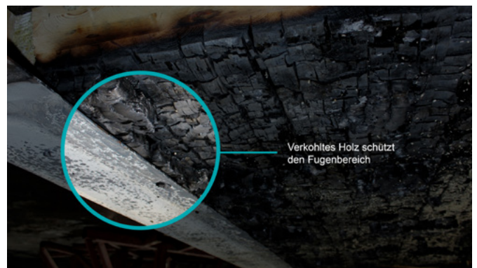
Abbildung 3. Prüfkörper von unten nach einem 90-minütigen Brandversuch unter Belastung.
