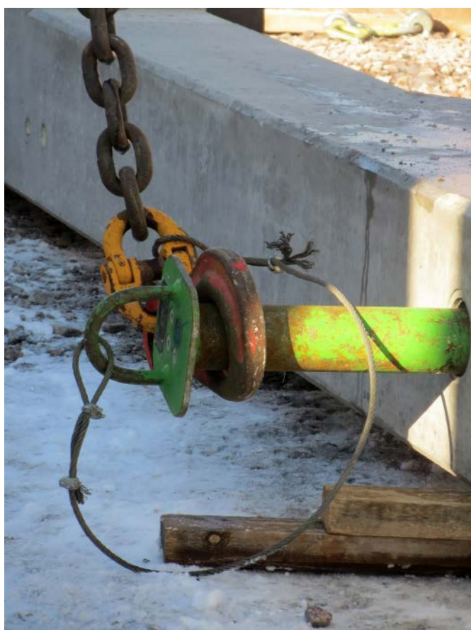
Figura 13. Collegamento del perno di sollevamento all'imbracatura di sollevamento con un cavo d'acciaio.
