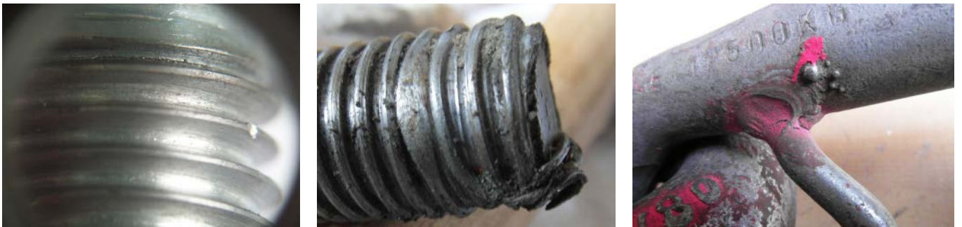
Kuva 31. Vaurio kierteen pohjassa / vaurioitunut kierre / hitsausmurtuma.
